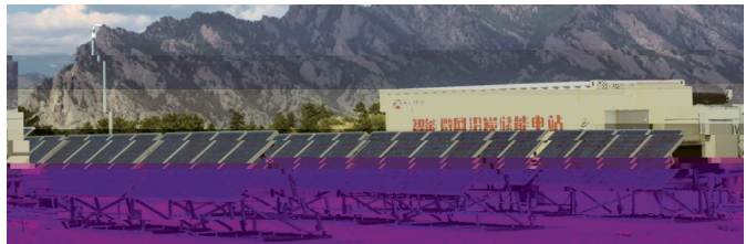
高性能鉛炭電池儲能項目
